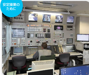
24時間体制のプラントコントロール
