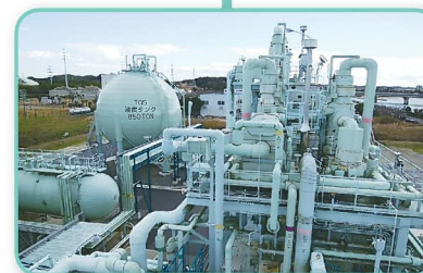
液化炭酸ガス製造プラント
